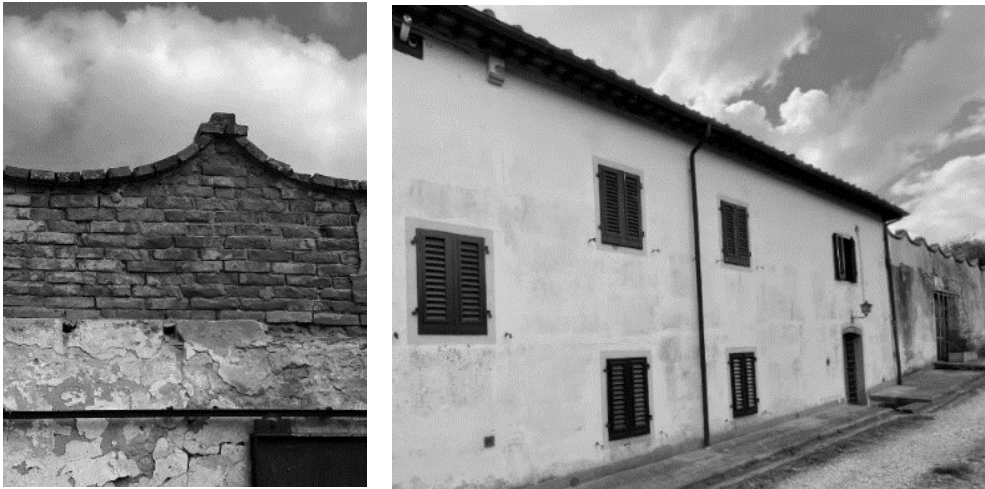
Figure 18. Photos prises en juillet 2021 avant les travaux. A gauche, un détail du toit de la Limonaia qui à cause de sa dégradation laisse visible les murs en briques. A droite, La Casa Colonica dans son état initial avec des persiennes aux fenêtres qui ont été critiquées, car elles entravaient la pénétration de la lumière naturelle à l'intérieur. On peut également observer la détérioration de l'enduit extérieur et l'absence d'alignement des fenêtres. Photos prises par Francesco Busi.
