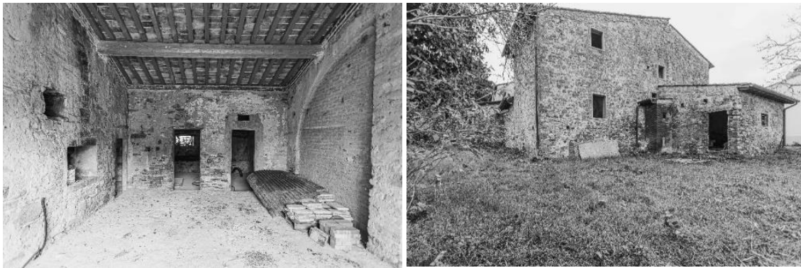
Figure 39. Photos prises avant le chantier quand la maison était en abandon. Photos prises du site internet de l'agence d'architecture Abitare.
