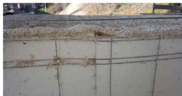
Fig 3.13 Cedimento pannello con 200 kg di carico
