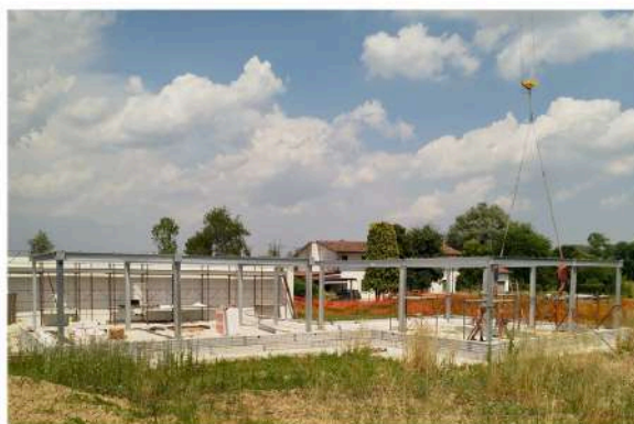
Fig. 4.6. Telaio in acciaio
